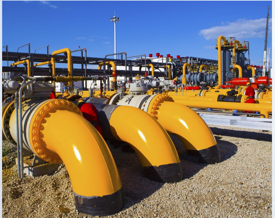
Der Dehydrierungsprozess in einer Erdgas-Aufbereitungsanlage stellte EagleBurgmann vor spezielle Herausforderungen.
